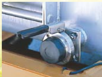
Vanne sur grille d'égouttage
